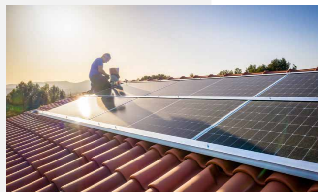
PV auf Gebäuden
